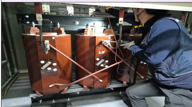
전기실 특고압 설비 점검
